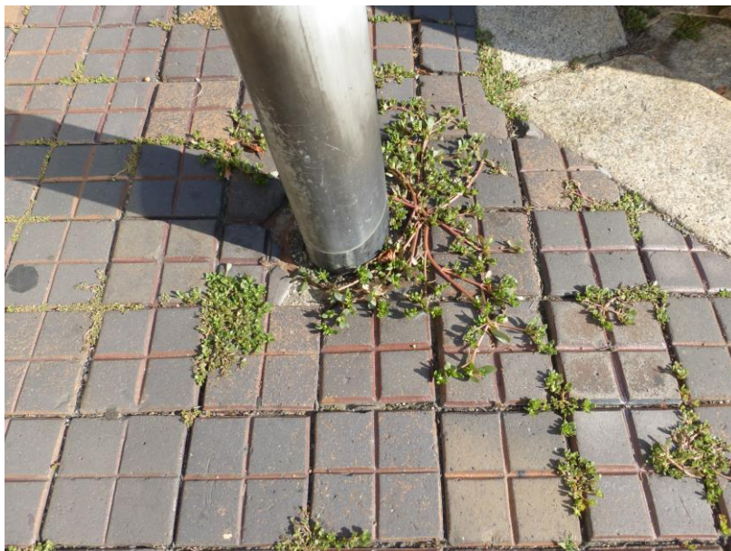
...zahlreich in Pflasterfugen in Wunsiedel (Fotos: M. Gorny)
